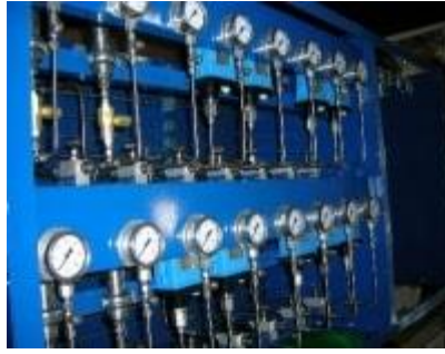
Photographie d'une servitude pneumatique
